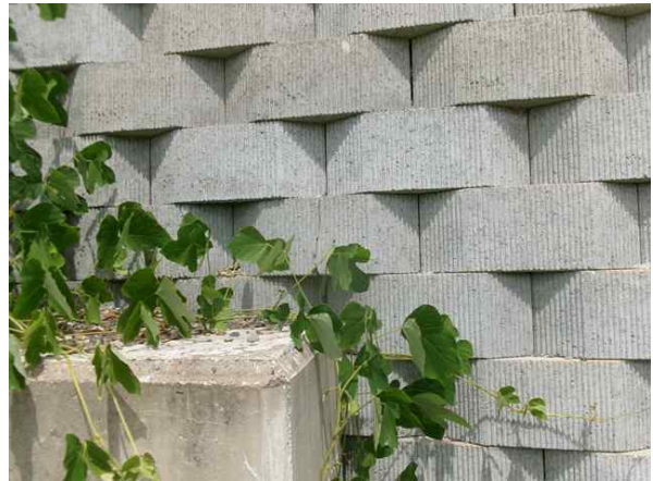
S3 블록 균열(1EA)
